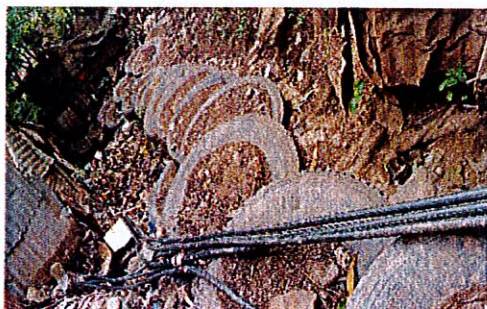
Photo 3 : Branchement illégaux de type spaghettis
